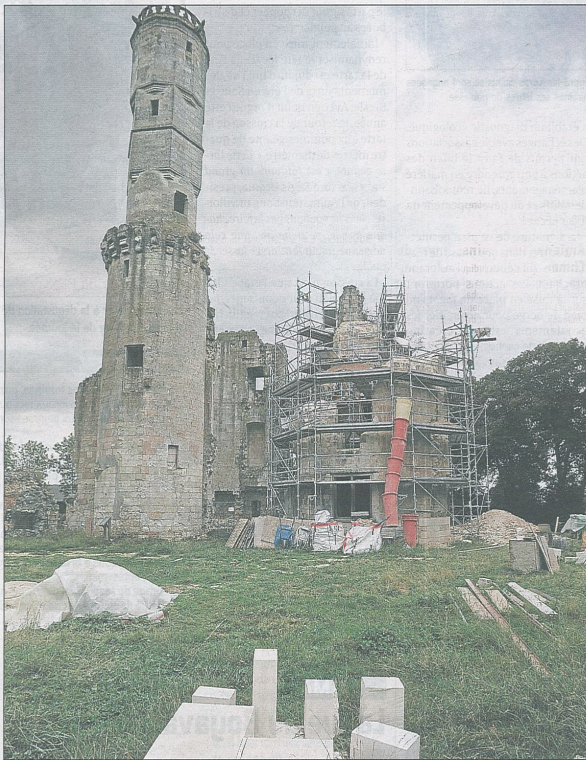
De nouvelles pierres venues des Charentes remplacent les anciennes du château de Folleville.
